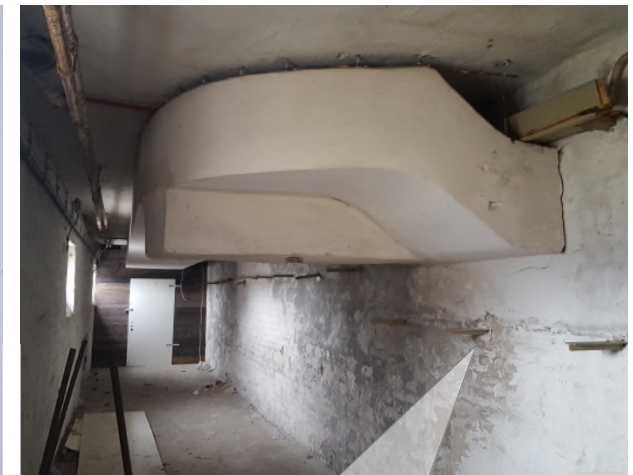
Leichtbauplatten Kanalverkleidung z.B. Promabest, Sokalit, hier Rabitz-Putz (asbestfrei)
