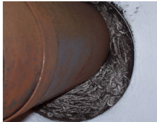
Asbestschnur als Stopfmasse in Wanddurchführungen
