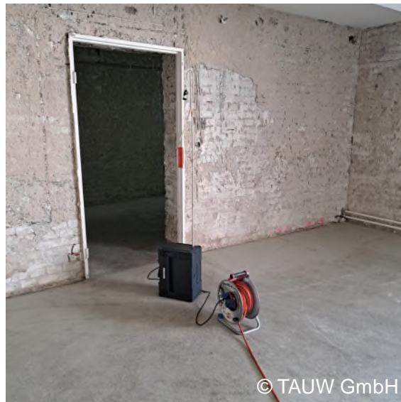
Asbest-Freimessung Erfolgsnachweis → Faserkonzentration < 500 \text{ F/m}^3 → Poissonwert < 1000 \text{ F/m}^3
