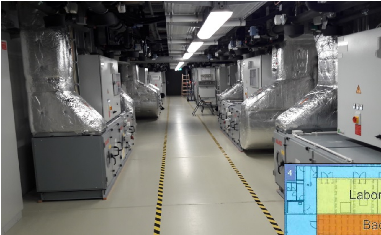
Ausschnitt einer Technikzentrale – Backbone
