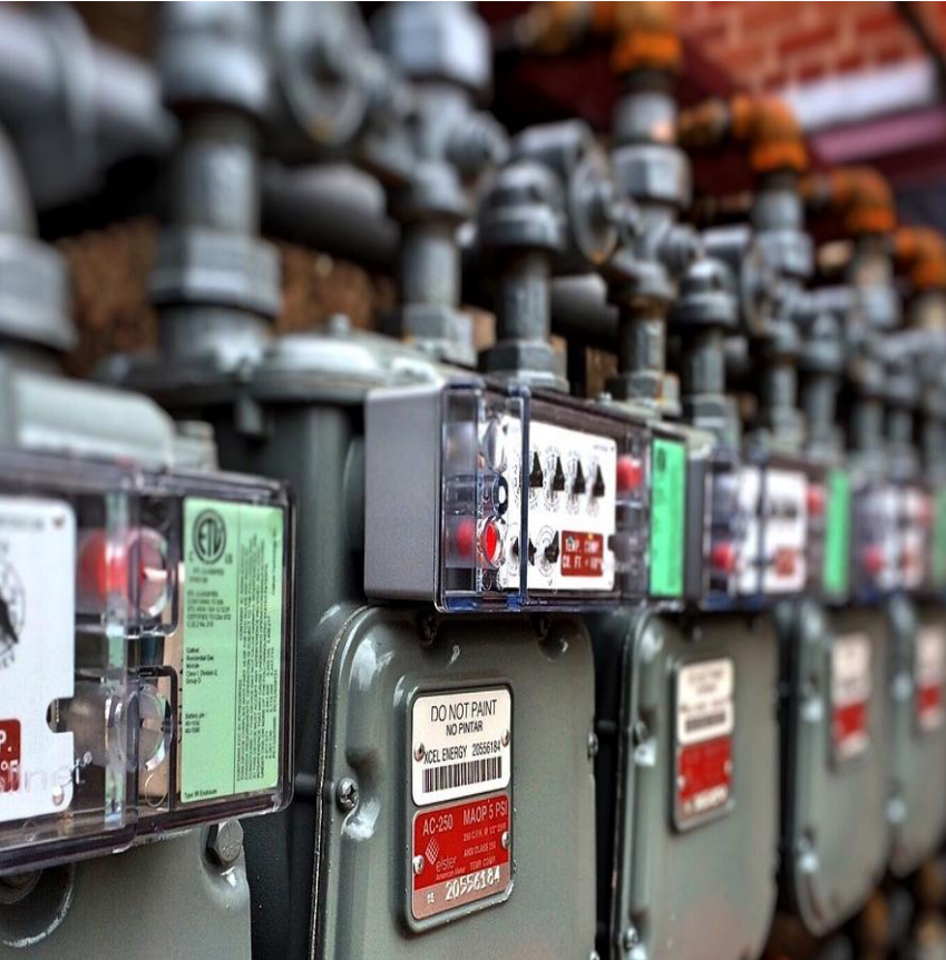
Energie- u. Medienversorgung
